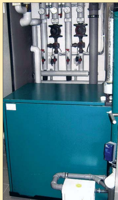
Beheizt wird das Hotel durch ein modernes Blockheizkraftwerk.
